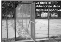
Lo stato di abbandono della struttura sportiva
