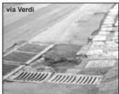
Via Verdi Le buche di ampie dimensioni, che cardine intorno al problema della sicurezza stradale, le improvvisi buche costrincono a continue frenate, a sterzate rapide. In alcuni tratti, la deformità del manto stradale, per la presenza del cemento accostato al bitume rende le frenate ancora irregolari. Se consideriamo la sicurezza di chi viaggia sui motorini la situazione si aggrava.
